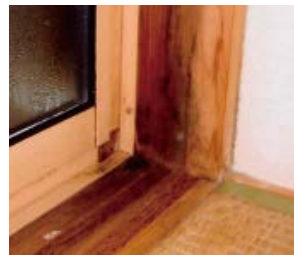
室内への雨漏り
